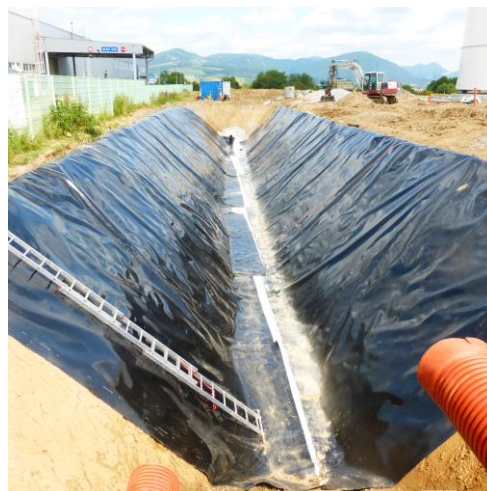
Retenčná nádrž Franke Strečno
