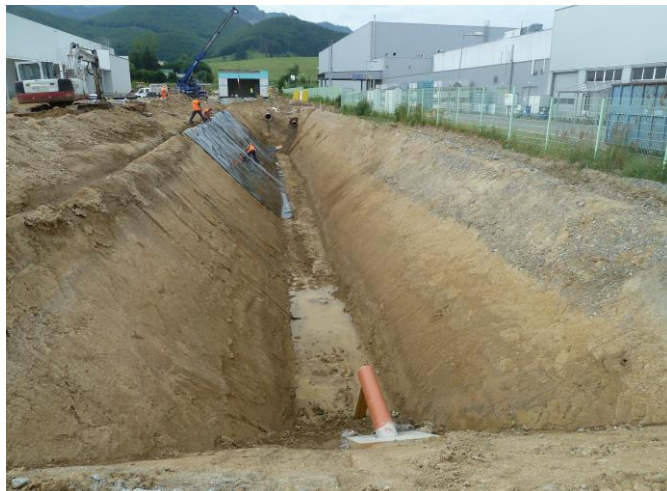
Retenčná nádrž Franke Strečno
